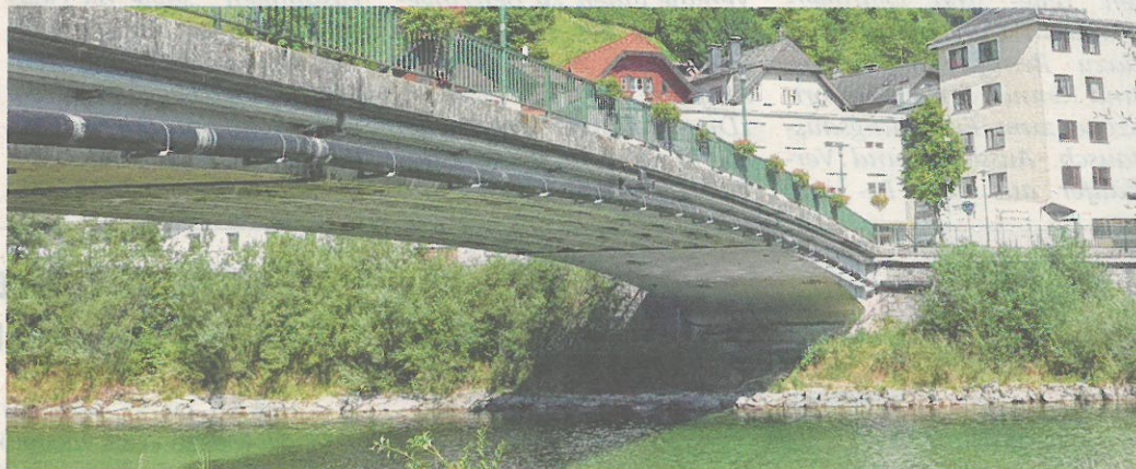
Die desolante Spannbetonbrücke muss abgerissen werden.
